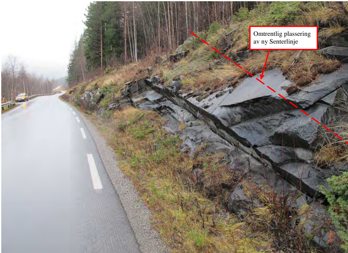
Foto 17: Profil ~18350, Tydelig oppsprekking parallelt vegen, foto tatt mot nord.
