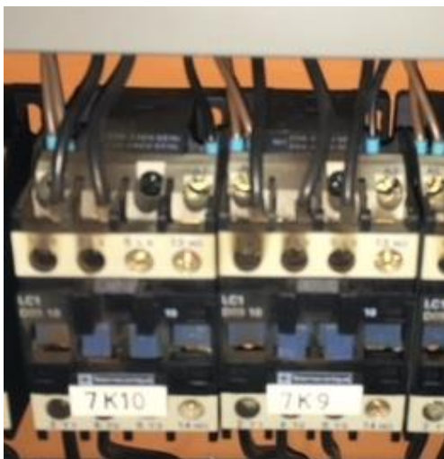
Figur 7 Varmgang i kontaktor i sikringskap.
