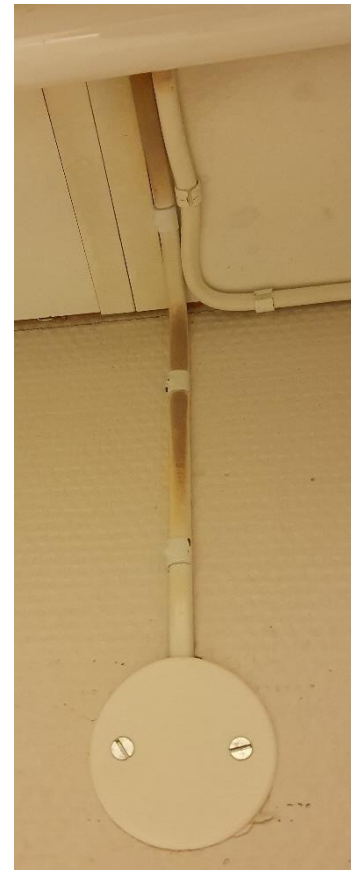
Figur 6 Varmgang i overbelastet ledning
