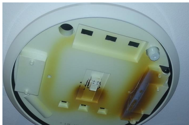
Figur 8 Armatur som utviklet varme rundt kontakt for lyskilden. Alle disse er skiftet ut.
