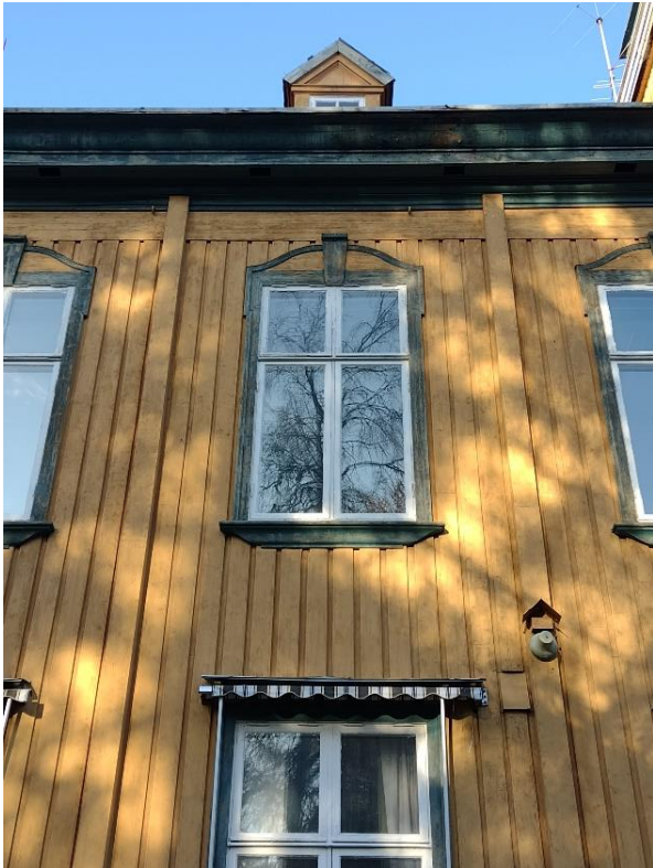
Figur 4-23. Fasadetalljer med jugendpreget vindusutforming, stående falsset panel og tidstypiske farger. (Foto: Henning Larsen)
